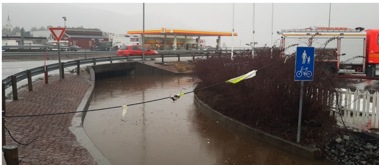
Figur 5-6 Gangkulvert under E39 fylt med vann under flom 4.1.2019. Foto: Ståle Wattø, kilde: Sunnmørsposten
